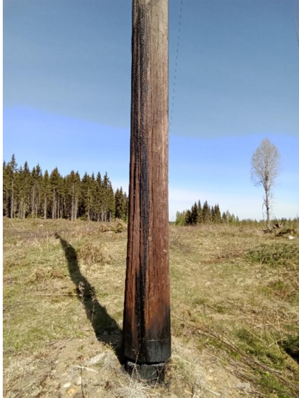
Kuva 1. Pylväässä nro. 6 oli uutta valumaa maaperään n. 7 cm etäisyydelle pylväästä.
