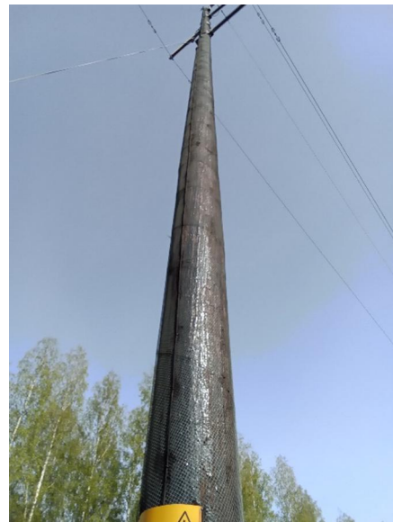
Kuva 8. Pylväässä nro. 58 oli havaittavissa kyllästeen tihkumista pylvään pinnalla. Valumaa maahan asti ei ollut.
