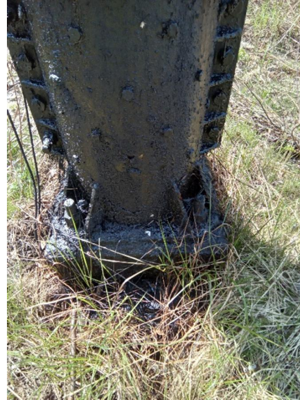
Kuva 2. Pylväässä nro. 21 havaittiin eniten valumaa maaperään n. 25 cm etäisyydelle pylväästä.
