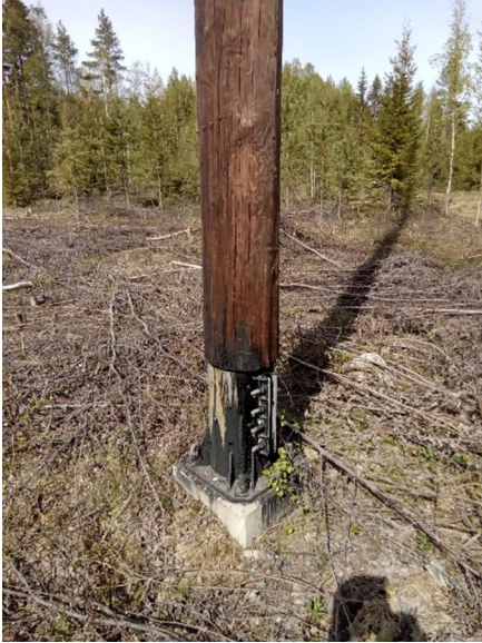
Kuva 5. Pylvästä nro. 42 oli uutta valumaa maaperään n. 10 cm etäisyydelle pylvästä.
