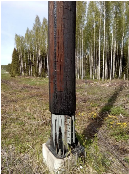
Kuva 3. Pylväässä nro. 28 oli uutta valumaa maaperään n. 10 cm etäisyydelle pylväästä.
