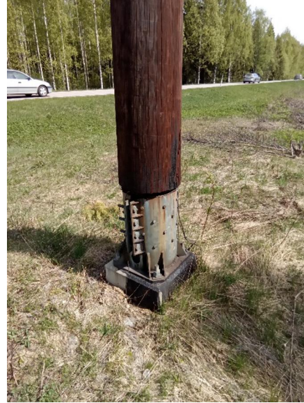
Kuva 6. Pylväässä nro. 44 ei havaittu enää kyllästeen tihkumista.
