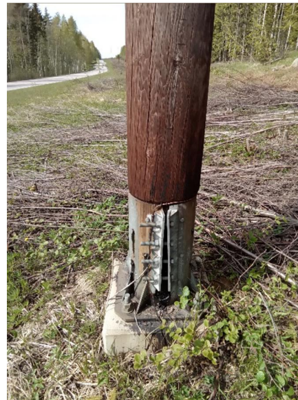
Kuva 4. Pylväältä nro. 32 oli uutta valumaa maaperään n. 5 cm etäisyydelle pylväästä.
