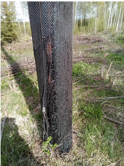
Kuva 7. Pylvästä nro 57 oli uutta valumaa maaperään n. 7 cm etäisyydelle pylvästä
