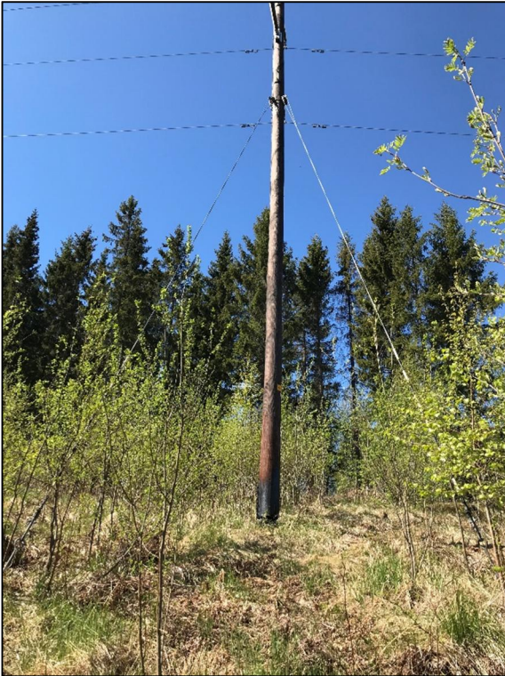
Kuva 01. Pylväs nro. 4. Tyviosassa on havaittavissa kyllästeen tihkumista.
