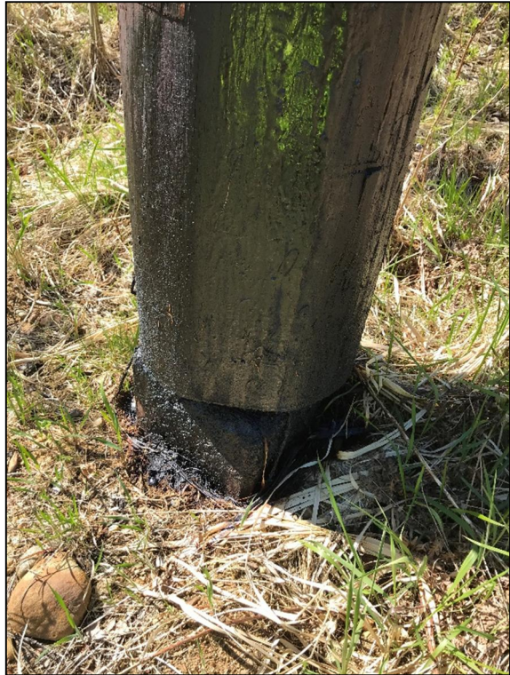
Kuva 02. Pylväs nro. 4. Maahan asti oli valunut kyllästettä.
