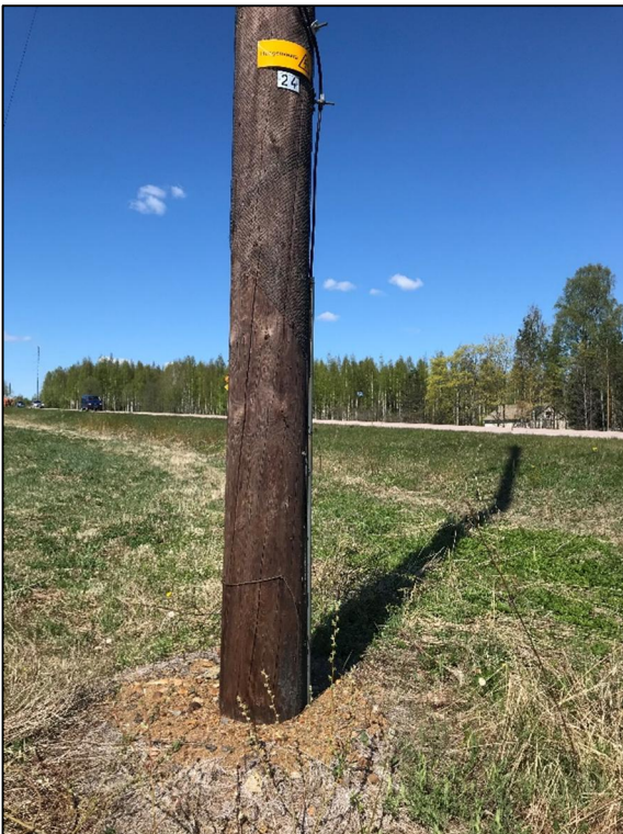
Kuva 03. Maahan perustettu pylväs nro. 24 oli kuiva. Kyllästettä ei ole valunut maahan vuoden 2018 toimenpiteiden jälkeen.
