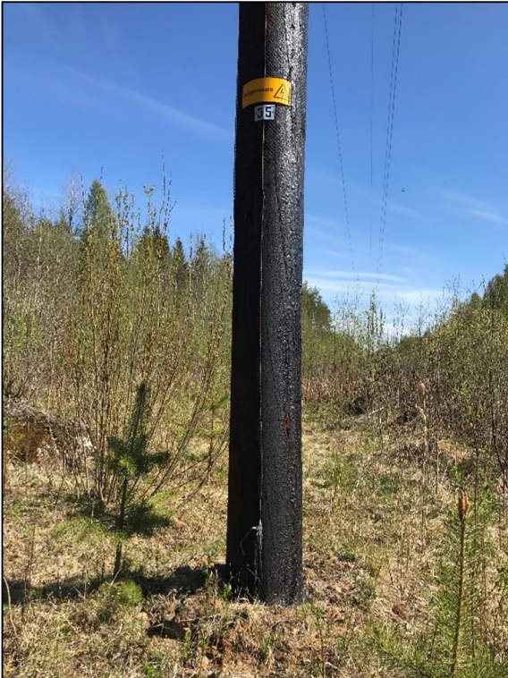
Kuva 05. Maahan perutetun pylvään nro. 35 pinnalla kyllästeen tihkumista oli havaittavissa koko pylväässä.
