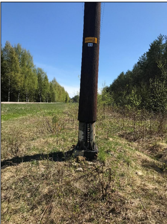
Kuva 07. Tarkkailukaivon läheisestä pylväästä nro 44 havaittiin kyllästeen tihkumista pylväästä.
