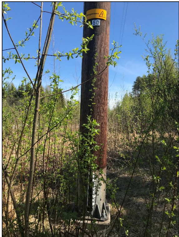
Kuva 04. Jalustalle perustettu pylväs nro. 50 oli kuiva. Kyllästettä ei ole valunut maahan vuoden 2018 toimenpiteiden jälkeen.
